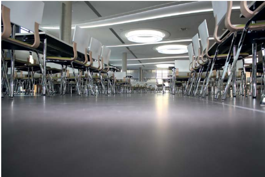
Die fertig verlegte Bodenfläche im Mitarbeiterrestaurant sollte ein monolithisch wirkendes Gesamtbild ergeben.
