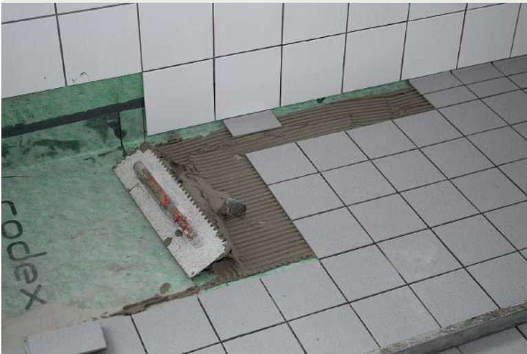
Die Verlegung der Wand- und Bodenfliesen erfolgte mit einem flexiblen Dünnbettmörtel, der dank seiner frühen Erhärtung einen zügigen Arbeitsfortschritt gewährleistet.
